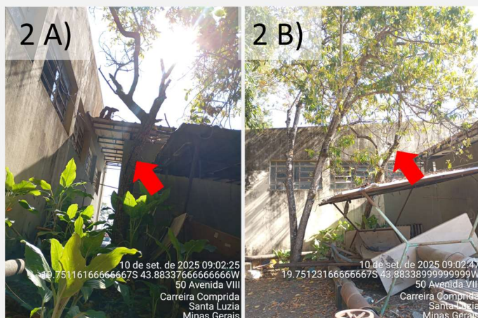
Figura 2 – A) Evidência ao espécime vistoriado B) Tronco inclinado para a edificação civil
